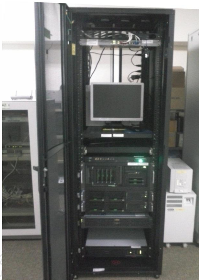
ภาพที่ 4.7 แสดงภาพของระบบเซิร์ฟเวอร์เสมือนหลังการติดตั้งเสร็จ
