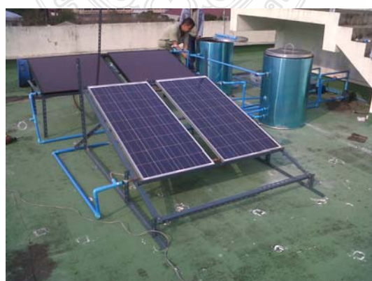
ภาพที่ 4.41 ระบบผลิตน้ำร้อนพลังงานแสงอาทิตย์ที่ใช้ในการทดสอบ
