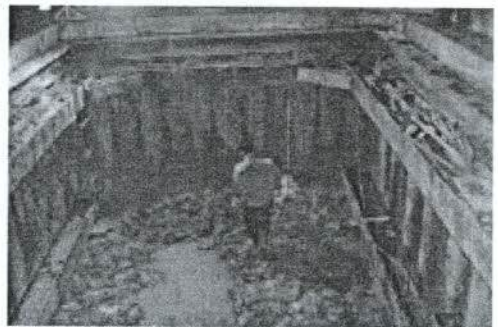
รูปที่ 6 บ่อตันและบ่อรับแบบใช้เข็มพืด (Sheet Pile)
