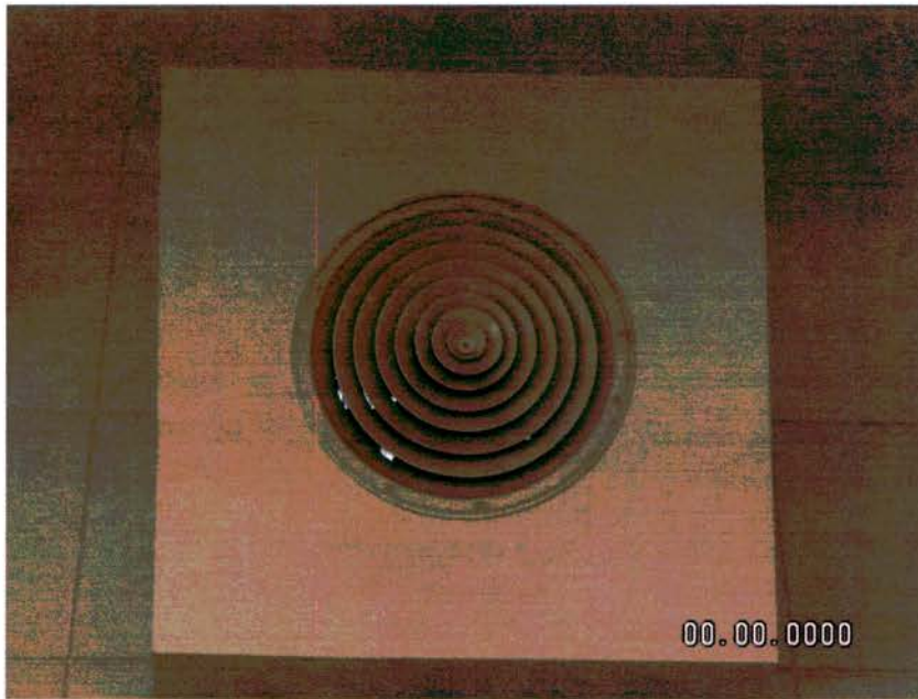
ภาพที่ 3.28 ระบบปรับอากาศและระบายอากาศ
