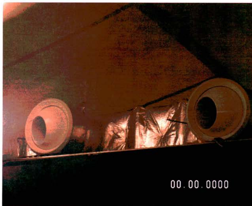
ภาพที่ 3.29 ระบบปรับอากาศและระบายอากาศ
