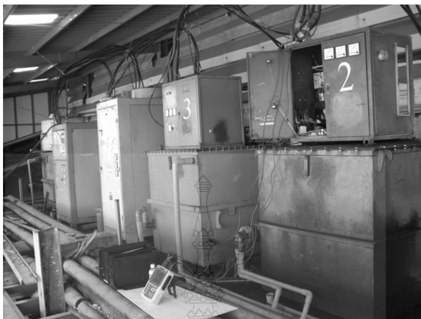
ภาพที่ ข.3 เครื่องวัดคุณภาพไฟฟ้าที่หม้อแปลงหุบหลุมเนียม
