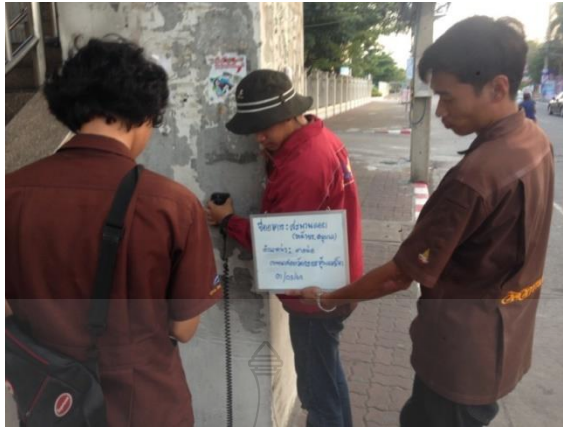
รูปที่ 3.6 การหาตำแหน่งเหล็กและการวัดระยะคอนกรีตหุ้มเหล็กเสริม
