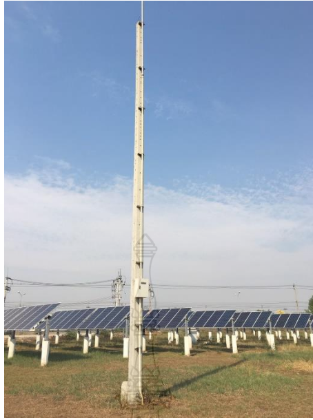
รูปที่ 4.6 ลักษณะการติดตั้งอุปกรณ์ของระบบล่อฟ้า
