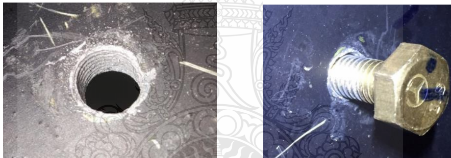
รูปที่ 4.11 จุดที่เกิดความเสียหายของรู Isolated Phase Bus ที่ทำการตีปเกลียวไม่ดี [16]
