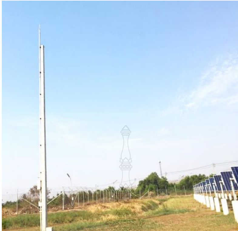
รูปที่ 4.26 การติดตั้งเสา ระบบล่อฟ้าแบบ ESE ให้กับโรงไฟฟ้าพลังงานแสงอาทิตย์
