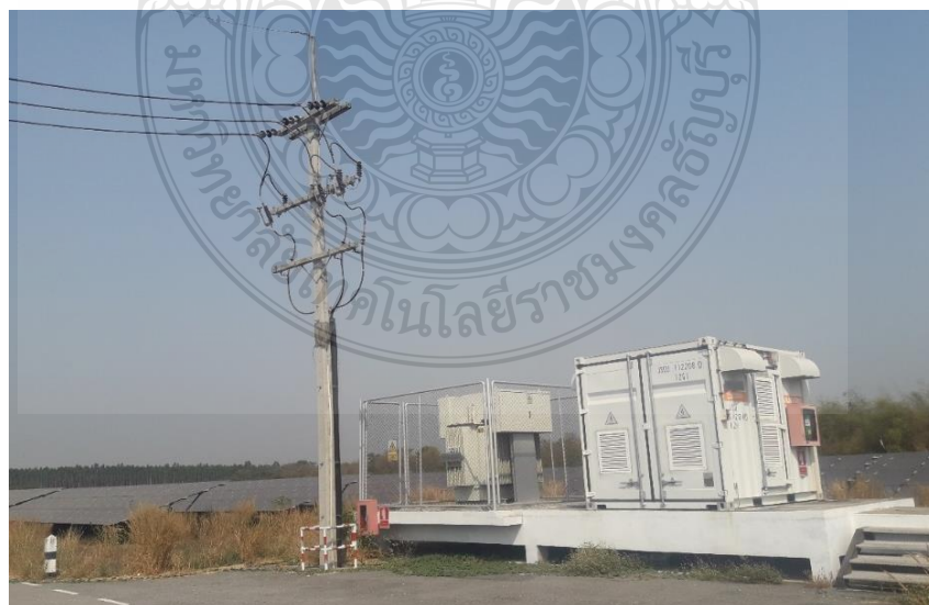
รูปที่ 3.5 การติดตั้งอินเวอร์เตอร์ที่ใช้งานในโรงไฟฟ้าพลังงานแสงอาทิตย์ที่ศึกษา
