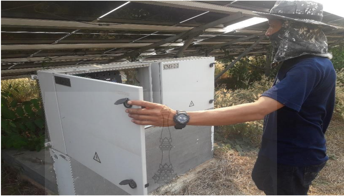
รูปที่ 3.15 การตรวจเช็คสภาพการทำงานได้แผง และสภาพของแผงเซลล์แสงอาทิตย์ที่ศึกษา
