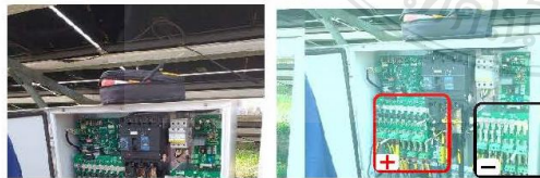
(c) PV string combiner box (d) Common positive and negative
