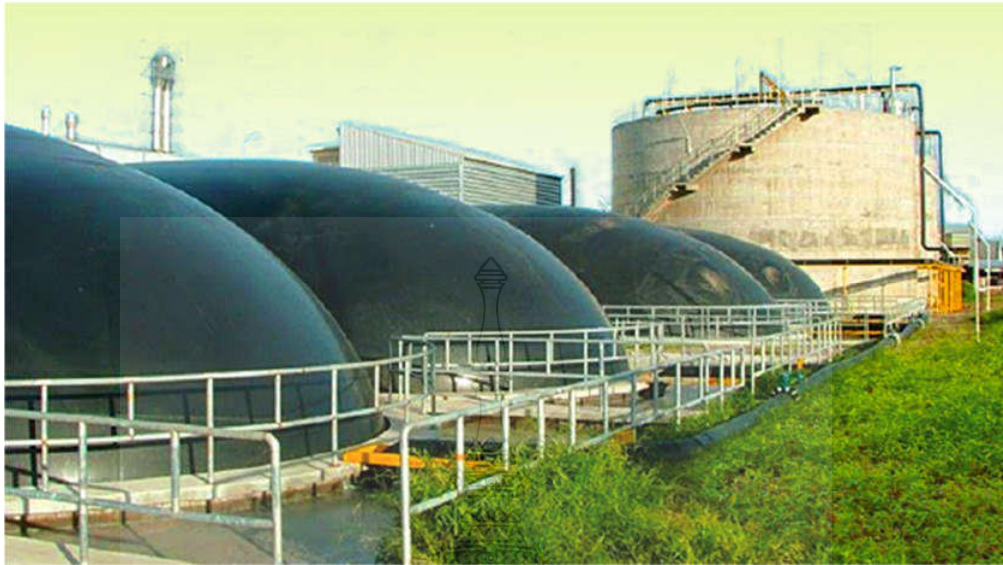
รูปที่ 1.1 แสดงโรงงานอุตสาหกรรมที่มีการติดตั้งระบบผลิตและใช้ก๊าซชีวภาพ [6]
