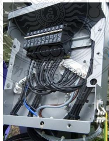
รูปที่ 2.45 กล่องต่อสายร่วมของแผงเซลล์แสงอาทิตย์ขนาด 4 kW รวม 10 แผง เพื่อป้องกันในสายเคเบิลเดี่ยวไปยังตัวควบคุมการชาร์จ
