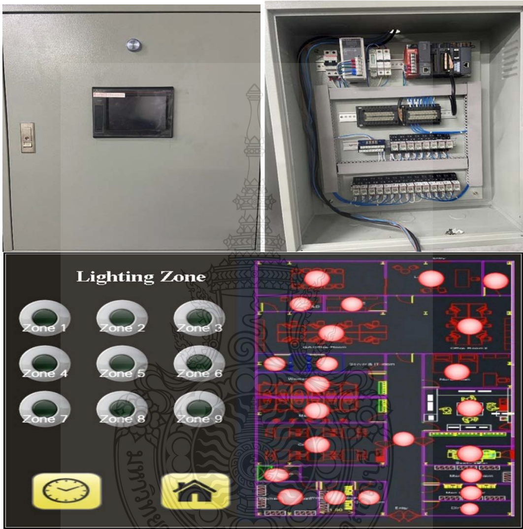
รูปที่ 3.13 อุปกรณ์ที่ทำการติดตั้งและแสดงผลการทำงาน
