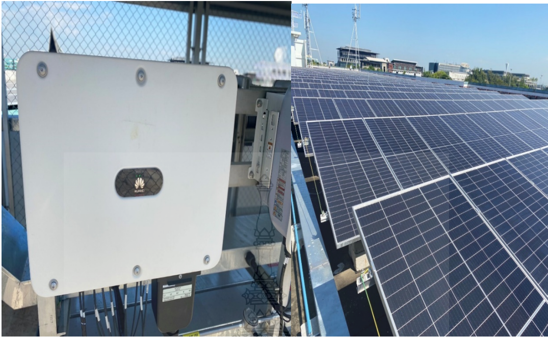
รูปที่ 3.19 การติดตั้งระบบพลังงานแสงอาทิตย์บนหลังคา
