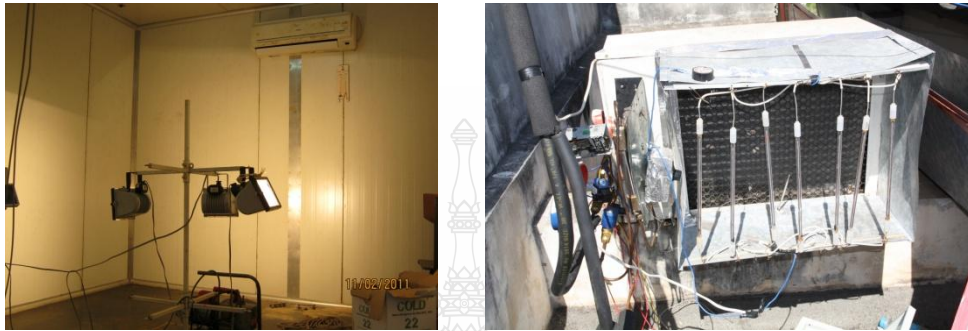
รูปที่ 3.12 ติดตั้งชุดควบคุมอุณหภูมิภายในห้องและที่ชุดคอนเดนเซอร์
