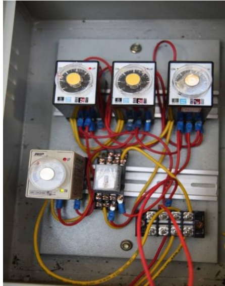
รูปที่ 3.16 ชุดวงจรควบคุมระบบปรับอากาศ
