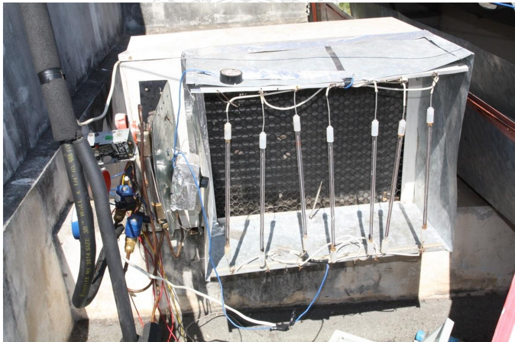
รูปที่ ก.10 ห้องเครื่องปรับอากาศ
