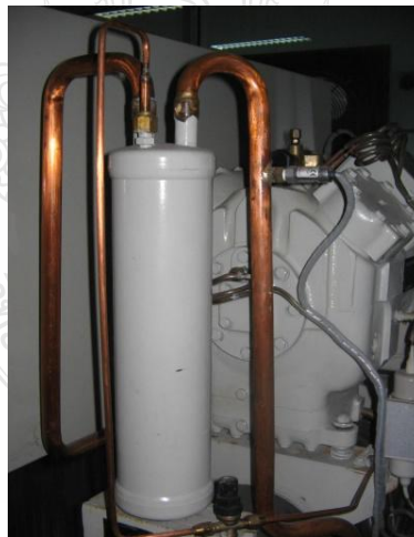
รูปที่ 2.3 อุปกรณ์แยกน้ำมันหล่อลื่น
