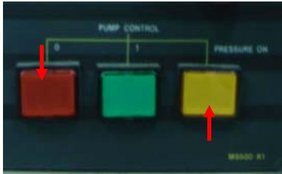
รูปที่ 3.126 Switch ด้านหน้าตู้ Control
