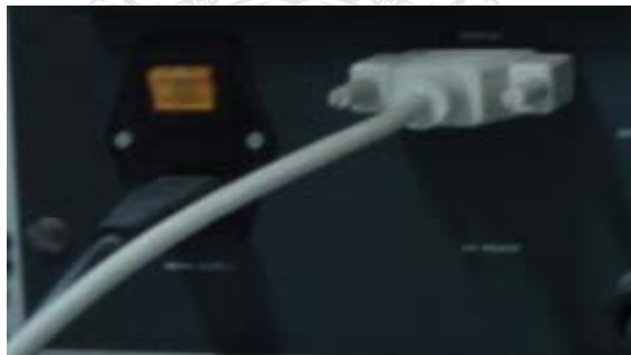
รูปที่ 3.127 Switch ด้านหลังของตู้ Control
