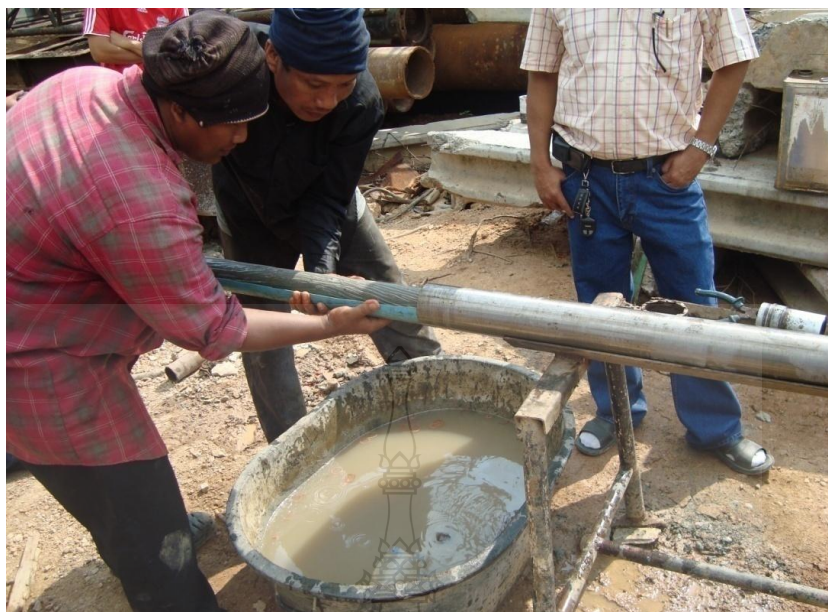
ภาพที่ ฌ.11 การนำตัวอย่างเนื้อเสาเข็มดินซีเมนต์ออกจากกระบอกละ
