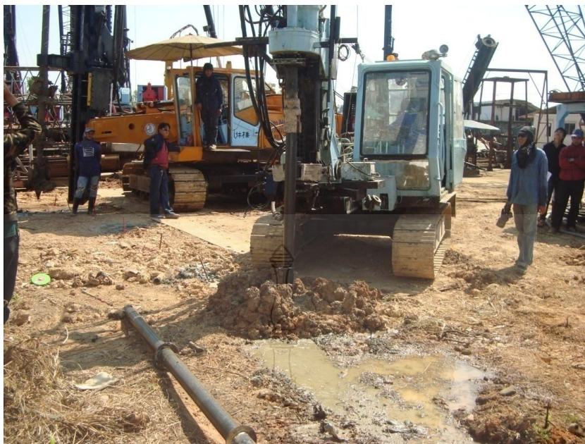
ภาพที่ ๗.๙ ใช้เครื่องจักรในการใส่แกนกลางลงในเสาเข็มซีเมนต์
