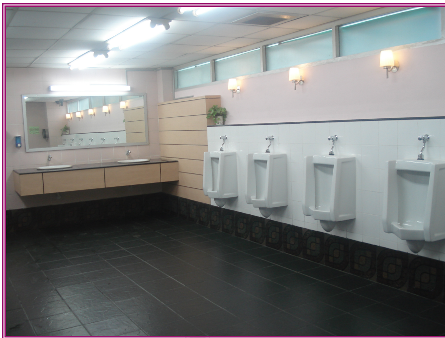
จัดห้องส้วม ปัสสาวะ สะอาด และเพียงพอแก่พนักงาน แยกห้องน้ำ หญิง ชาย
